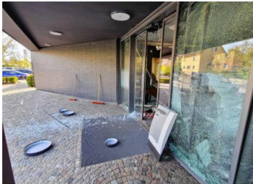
Am Tag nach der Geldautomaten-Sprengung in der Volksbank in Albrück geht die Aufarbeitung der Tat weiter. FOTO: MARKUS BAIER
